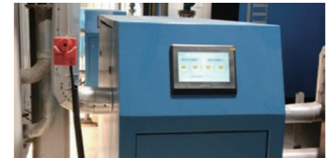
空压机余热回收改造
